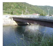
写真 鋼橋の腐食
