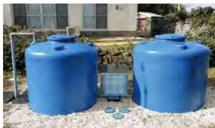
大型雨水貯留槽6m 3
